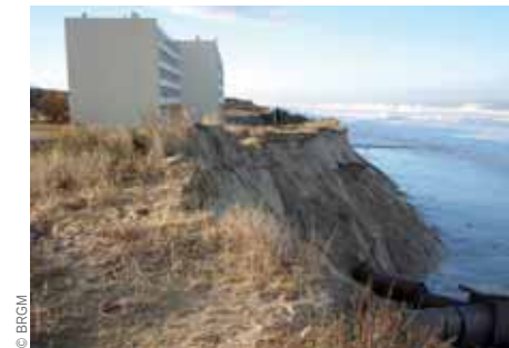
Suite aux tempêtes de décembre 2013 et janvier 2014, une érosion inquiétante s'est formée à Souillac-sur-Mer, Aquitaine.
